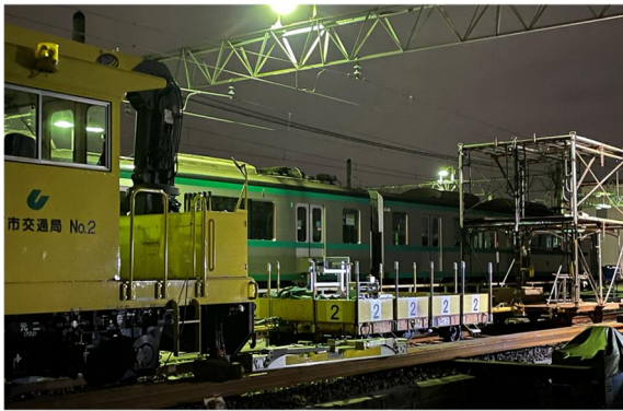
図 2.3-10 車両基地での搭載状況
