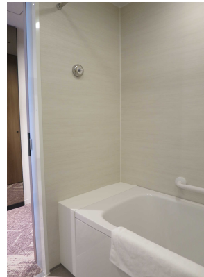
・移乗台、手すりを設けた浴槽
