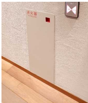
・廊下上の壁埋込型消火器ボックス
