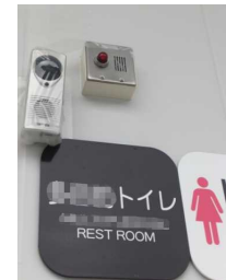
全ての便所の出入口には、音声案内装置を、臨時で設置した。
