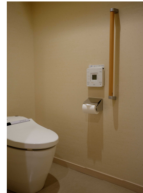
・便所の縦手すり
