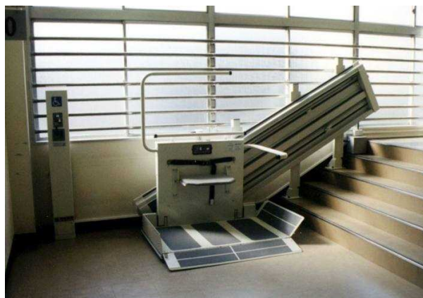
・既存施設の階段に設置した斜行型段差解消機
