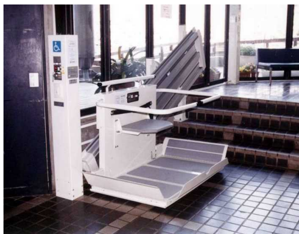
・既存施設のホール部分の階段に設置された斜行型段差解消機
