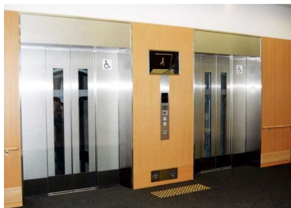
・エレベーター出入口戸のガラス窓、TVモニターの整備
