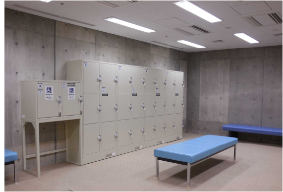
・ゆとりある広さ、車椅子使用者の利用に配慮した高さのロッカーのある更衣室
