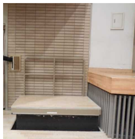
・舞台の袖に設けられた段差解消機
