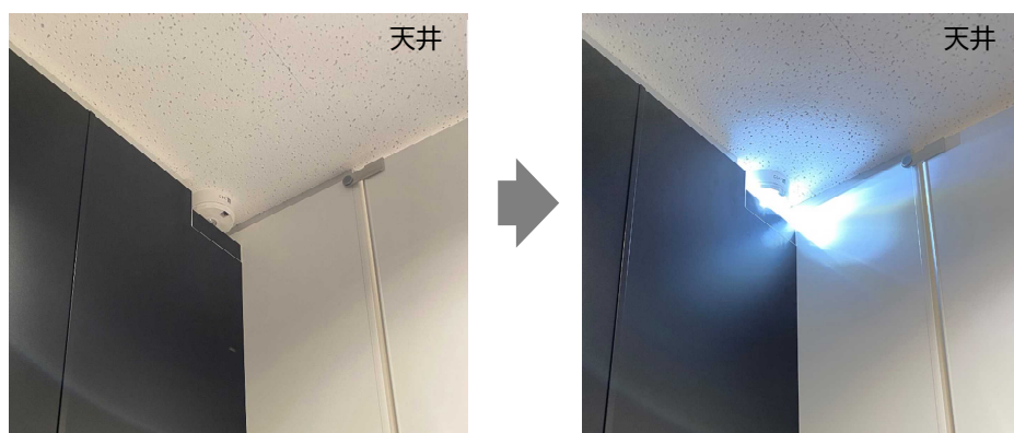
便房内（平常時） ・便所内の上部に設けられたフラッシュライト
