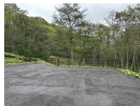
宮島岬に向かう道の入口に侵入防止を目的とした木柵を設置
