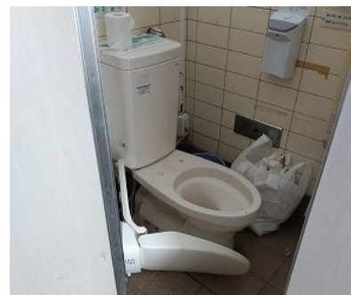
便座が壊され、ごみが溢れる トイレ
