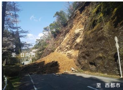
【被災状況写真】
