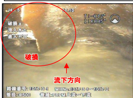
【汚水管損傷状況写真】
