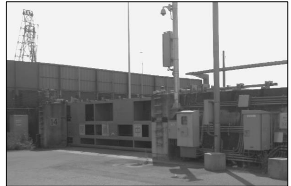
陸閘の電動化：尼崎西宮芦屋港海岸
