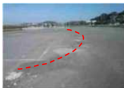
写真 3-6.2 エプロンの沈下、陥没
