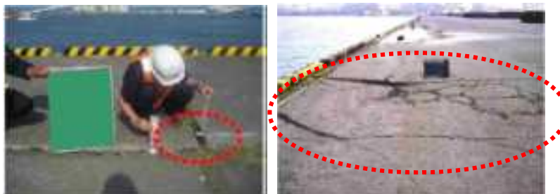
写真 3-2.2 エプロンの変状の事例
