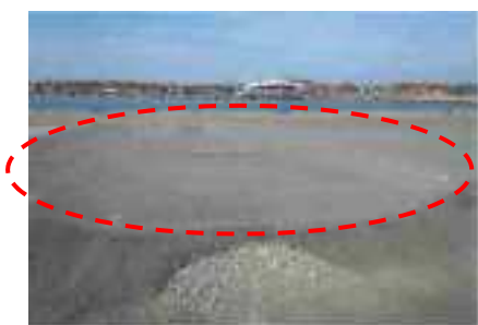
写真 3-6.1 エプロンの沈下事例
