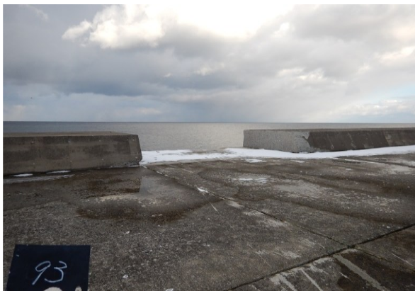
上部工の欠損
