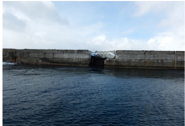
ケーソン・上部工の損壊
