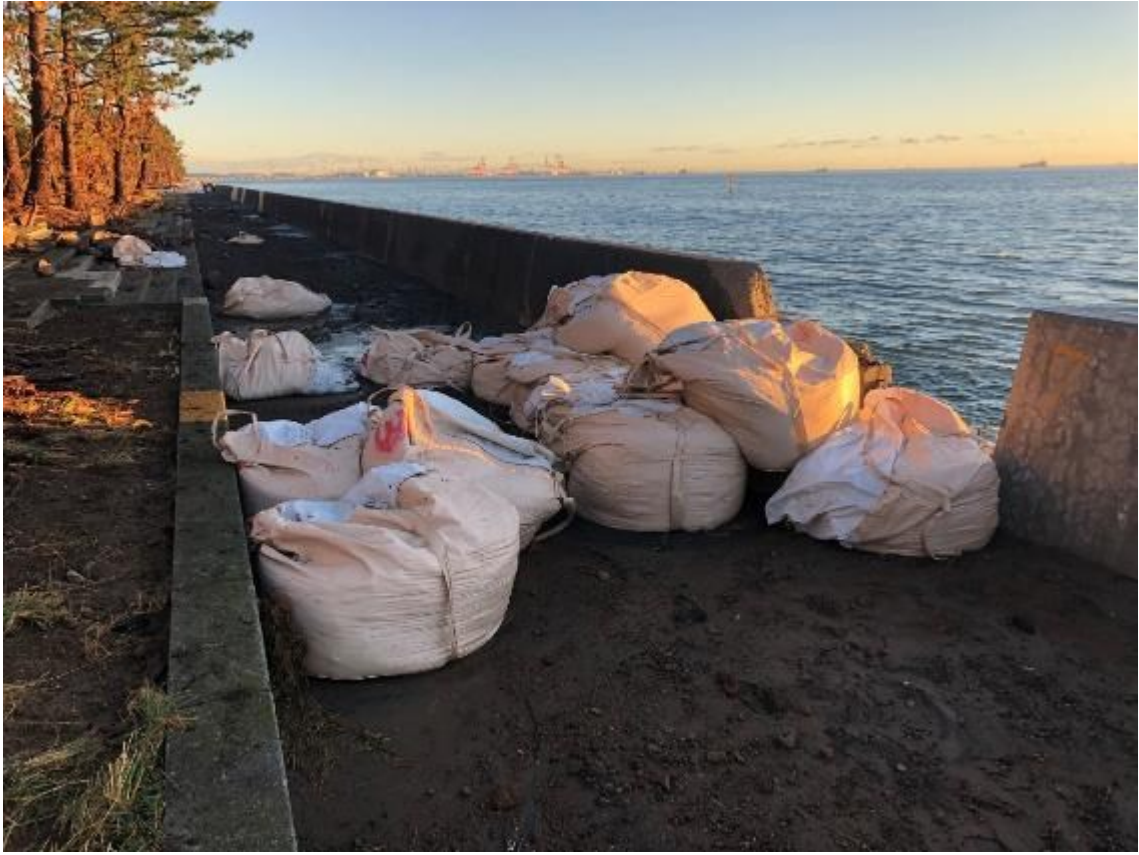
図－2 金沢区福浦地区土嚢の飛散状況
