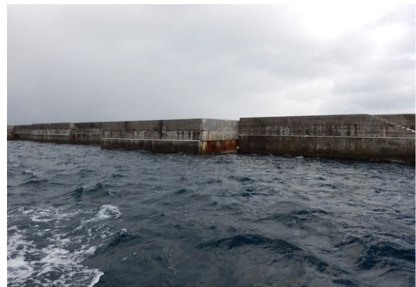
ケーソンの港内側への滑動
