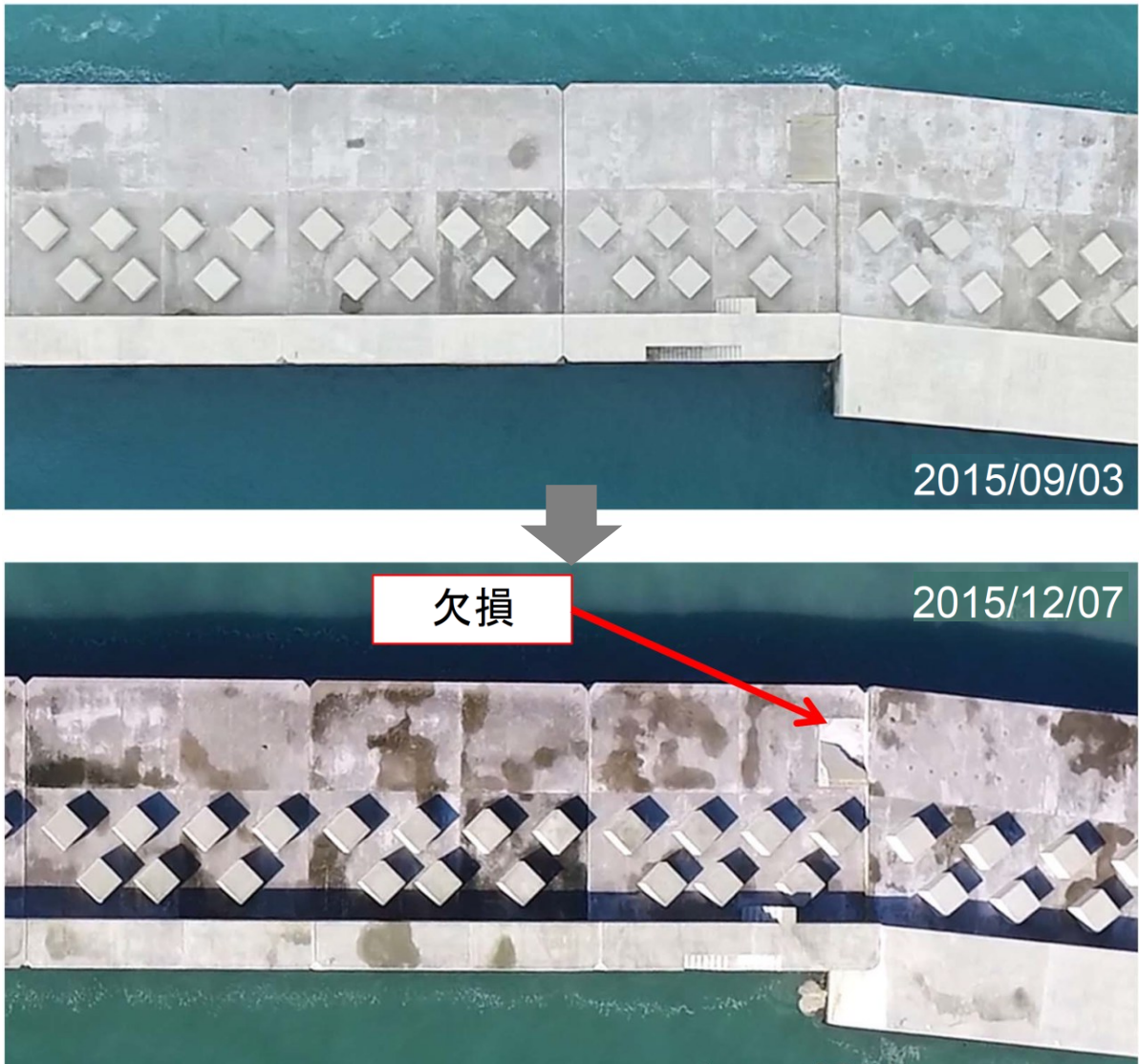
金沢港西防波堤 高波浪来襲前後の上部工比較
