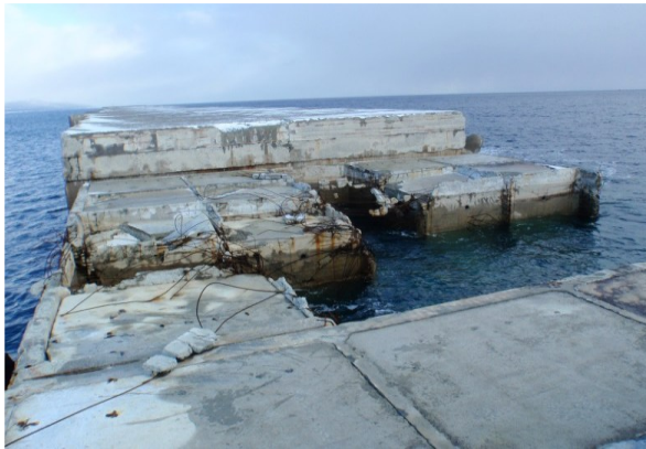
ケーソン・上部工の損壊
