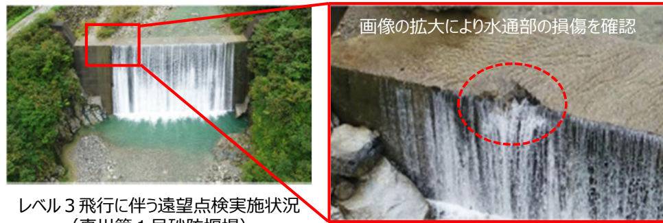
【施設の損傷を確認した事例：立山砂防事務所】
