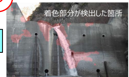
AI等を活用した施設変状箇所の自動抽出
