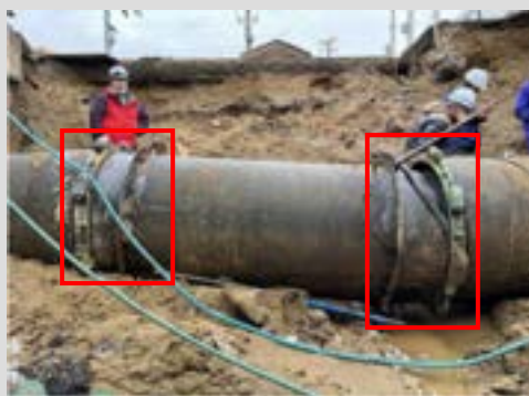
＜地震による送水管の継手の抜け出し＞
