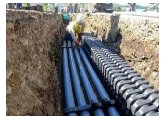
角型多条電線管の整備事例
