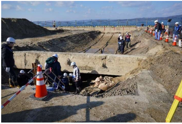
a) 矢板式護岸被害の調査
