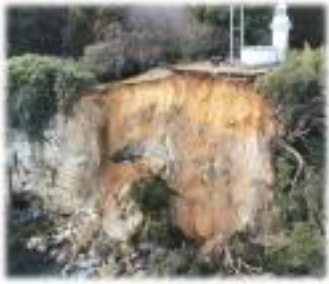
令和6年能登半島地震で被災した航路標識施設
