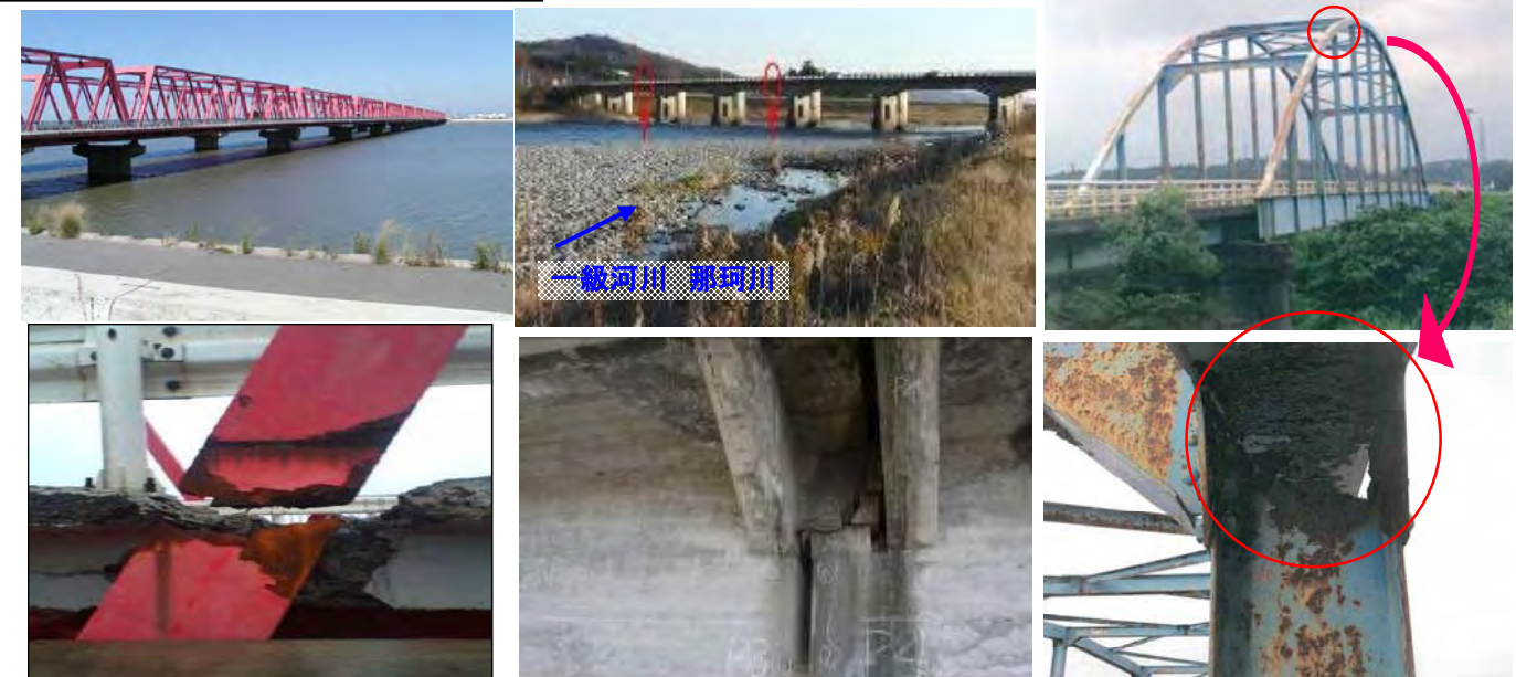
<木曾川大橋(国道 23 号)> ・斜材の破断(2007.6.20)
