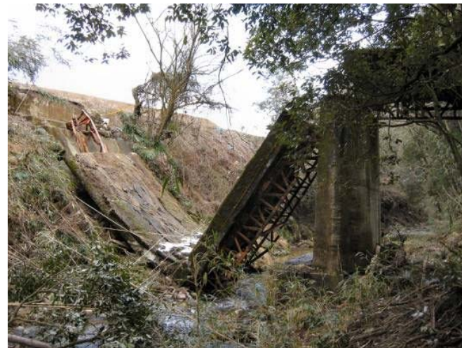
図 3-2 管理者不明橋梁の崩壊事故(平成19年)
