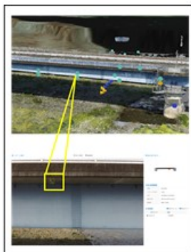
図3 3Dモデルより損傷(遊離石灰)確認イメージ図
