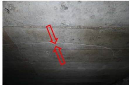
頂版のひびわれ
