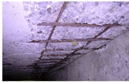
床版下面の鉄筋露出
