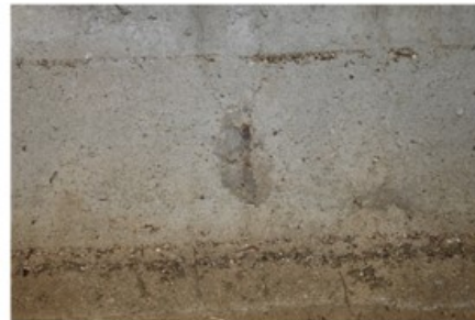
側壁の鉄筋露出
