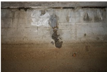
側壁のひびわれからの漏水
