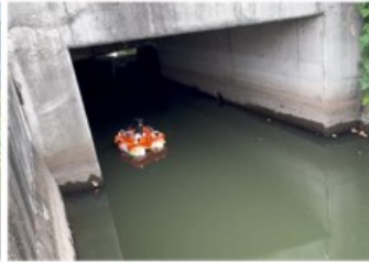
水路進入状況
