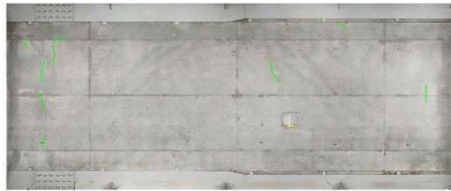
オルソ画像作成損傷部抽出
