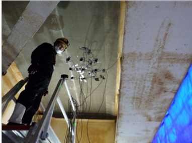
センサ設置状況
