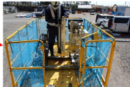
計測機器搭載状況
