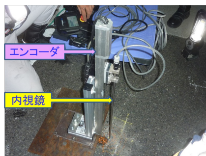
内視鏡による孔内撮影状況
