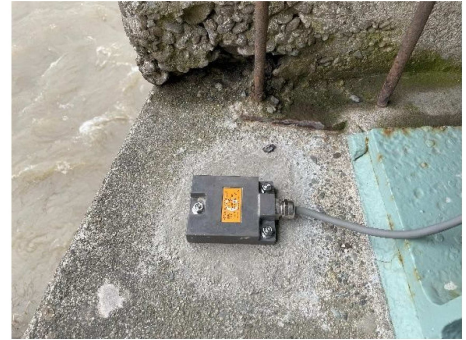
傾斜計の設置例
