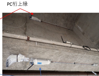
センサーの設置状況
