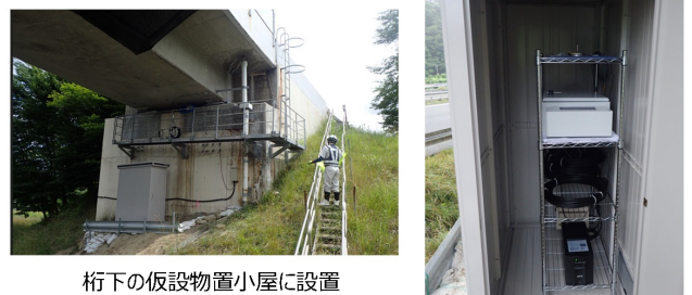
桁下の仮設物置小屋に設置
