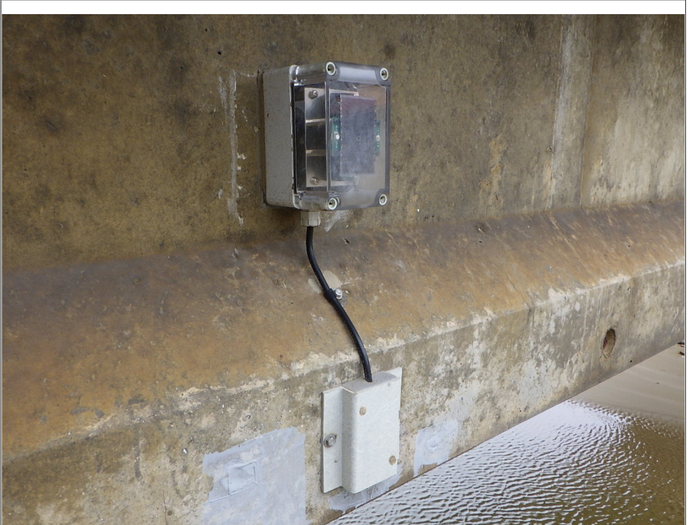
EcorrLIGHT腐食報知システムの設置状況
