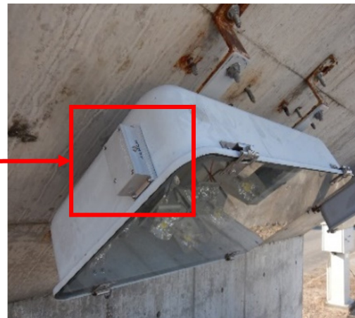
照明灯具への取付状況
