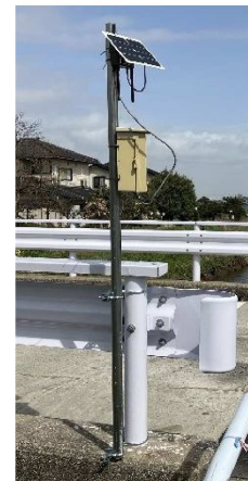
写真2 通信機設置状況
