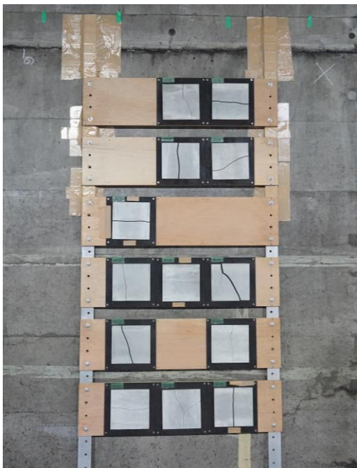
ひび割れパネル状況(遠景)
