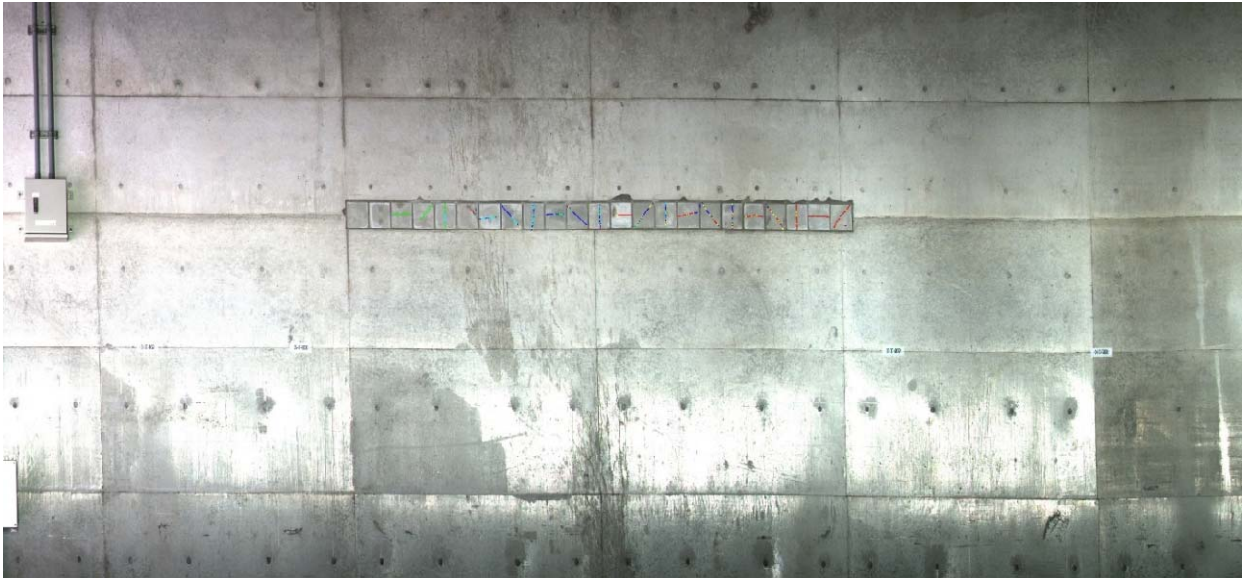
ひび割れパネル現地撮影写真(ひび割れ抽出済み)
