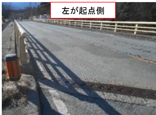
※舗装は部分補修されている。
