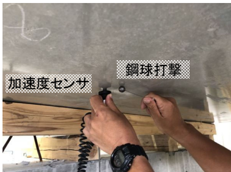
写真1 計測機器の設置状況
