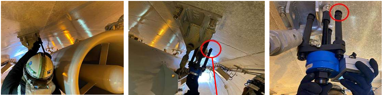
3本脚のうち1本が設置面に届かなかった
