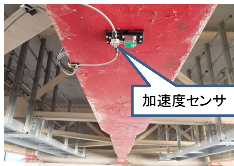
写真-1 センサ設置
