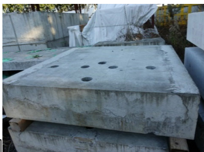
供試体③ 空洞箇所
