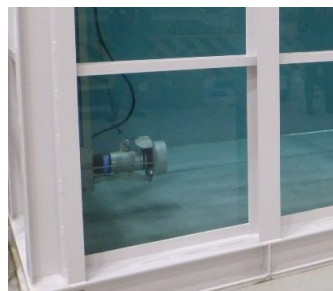
写真-12 流速装置(攪拌機)
