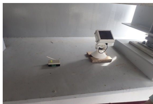
写真-4 設置(ゲートウェイを橋梁部)
