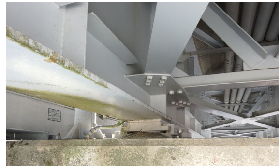
添架管路があり桁間が飛行不可 ドローン点検
