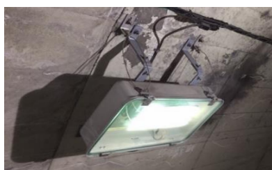
照明灯具(Aトンネル) 状態:健全
