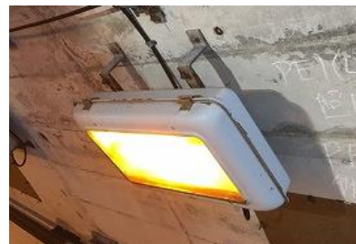
照明灯具(Bトンネル) 状態:表面腐食
