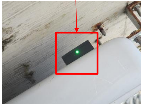
ボルト緩み有り(点灯)
