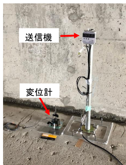
写真4 送信機 (設置状況)
