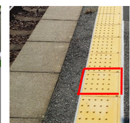
内方線付き点状ブロック
